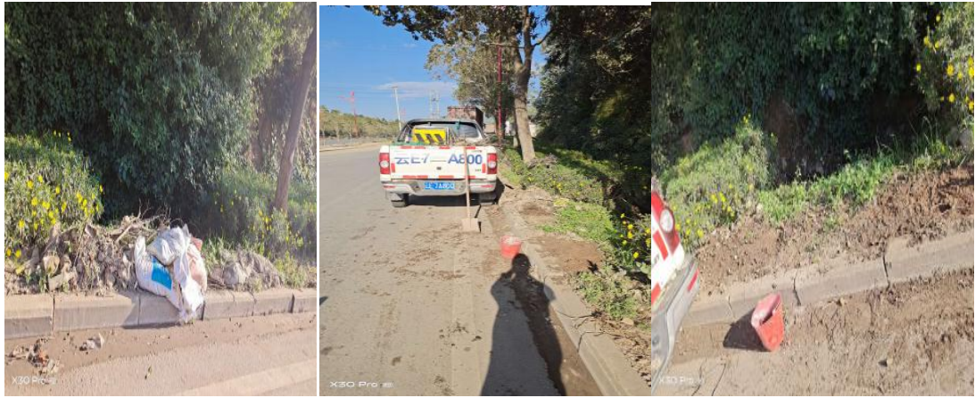
2、牟定县：牟定至楚雄 S219 省道，背阴村路段 1 处有建筑垃圾（经度 101.45129，纬度 25.23618）已清理。
