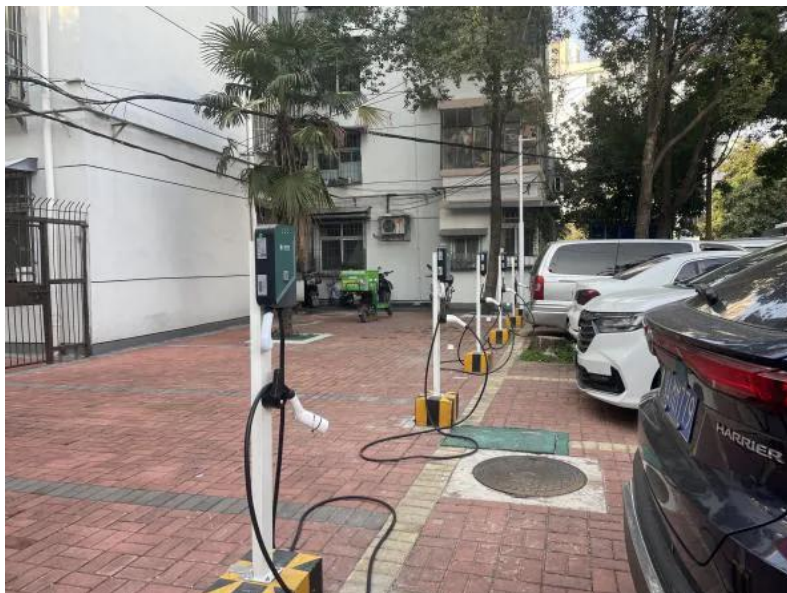
东亭社区新能源充电桩
